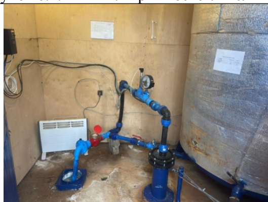
Рисунок 6.4.16 – оборудование скважины п. Новый
